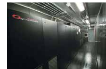
Powerhouse™ di Active Power Inc – un UPS di ben 1.2 MW di tipo "plug & play" integrato in un container standard ISO da 40 piedi (12 metri).
